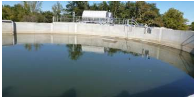
Unité « Licorne » - vue sur un des bassins de décantation
